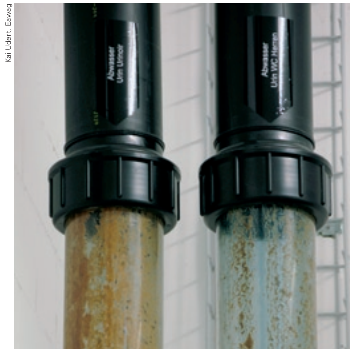
Les conduites d'évacuation des urines verticales et de grand diamètre permettent d'éviter les risques d'obstruction.
